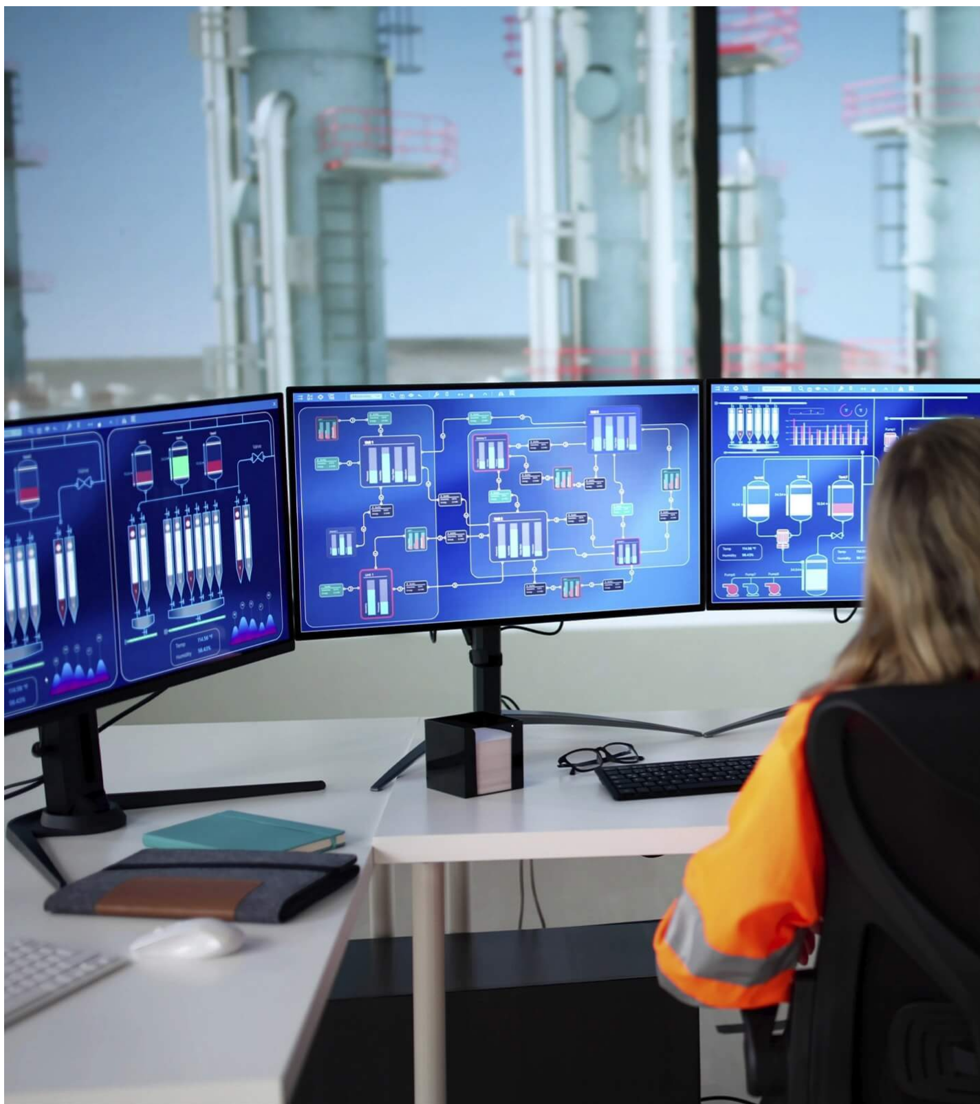
石油精製施設
